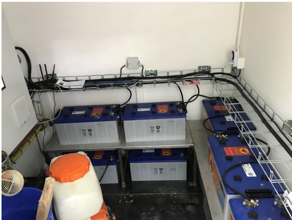
Obrázek č. 6 Bateriové úložiště
