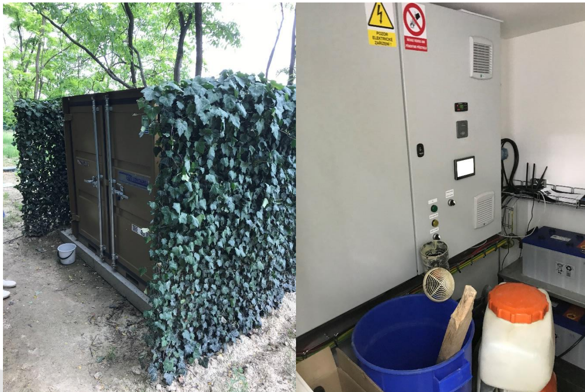
Obrázek č. 9 Stavební objekt a technologie umístěná ve stavebním objektu
